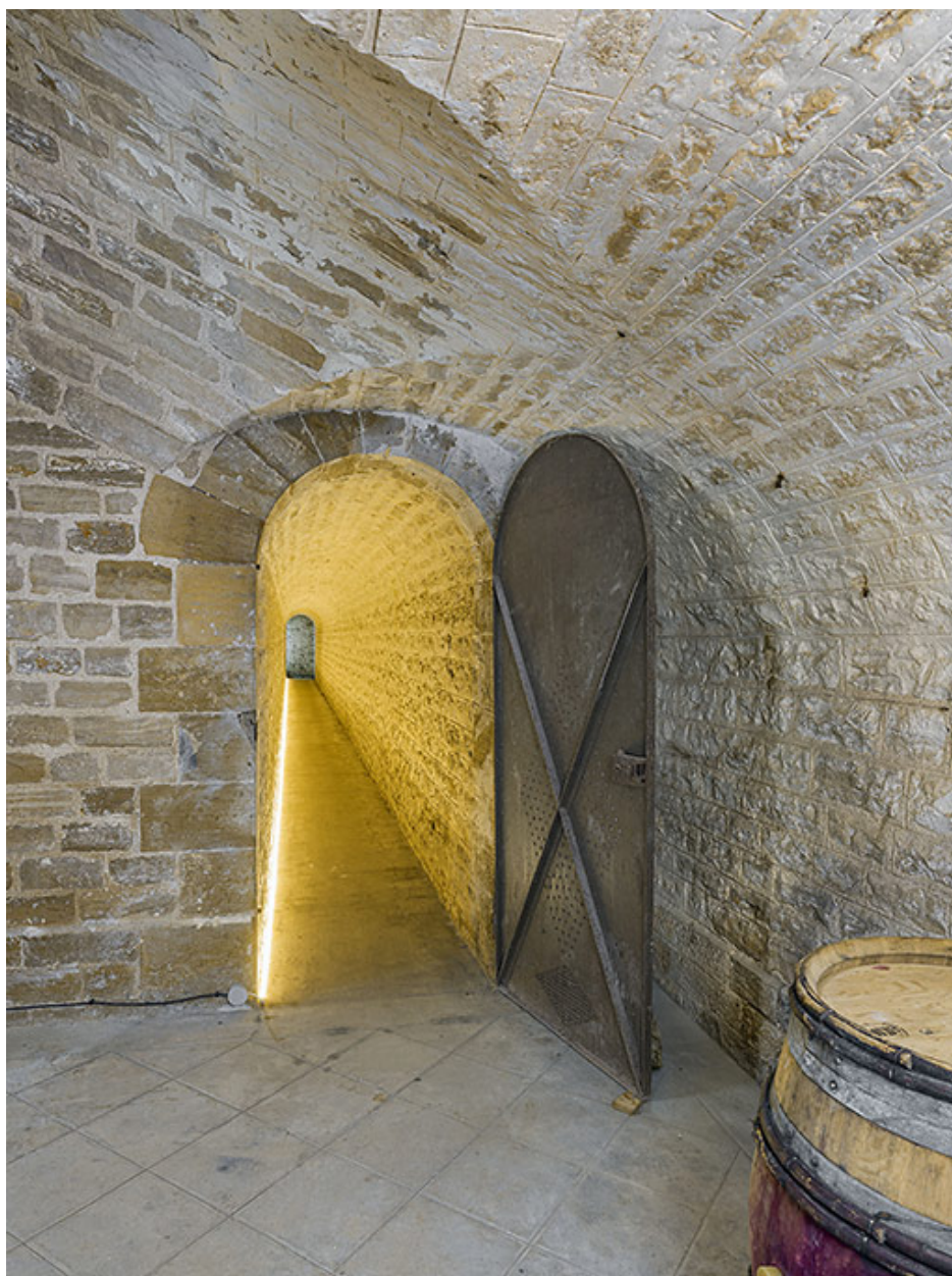
Galerie d'assainissement (droite).
