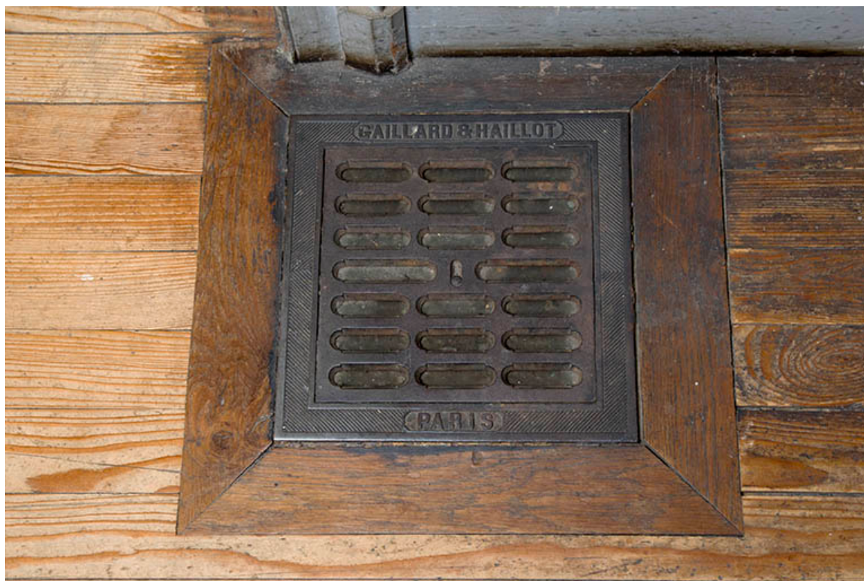
Grille de ventilation du chauffage central.
