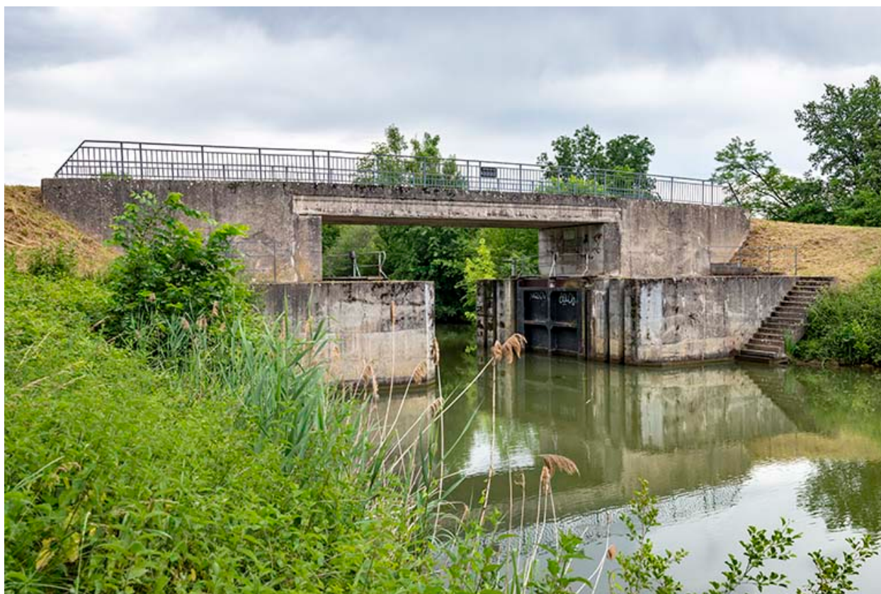
Vue aval de la porte de garde.
