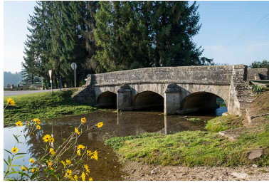
Vue depuis l'aval de la rivière. Phot. Jérôme Mongreville IVR43_20167001653NUC4A
