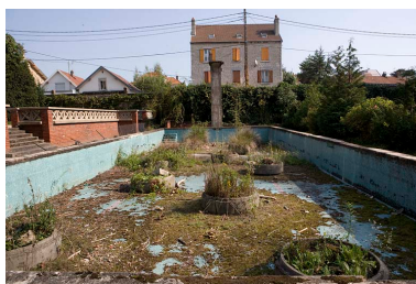
Piscine : le bassin à l'abandon.
