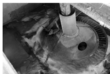
Forge Neuve. Bâtiment d'eau (L) : partie supérieure de la turbine. Phot. Laurent Poupard IVR43_19883900311Z
