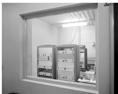
Salle des amplificateurs de distribution et des horloges à contrôler. Cette salle accueille les horloges à contrôler déposées par des clients extérieurs et les amplificateurs de distribution, qui dupliquent sans le dégrader en N exemplaires (N = 8 généralement) le signal provenant d'une horloge atomique. Phot. Jérôme Mongreville IVR43_20032500694V
