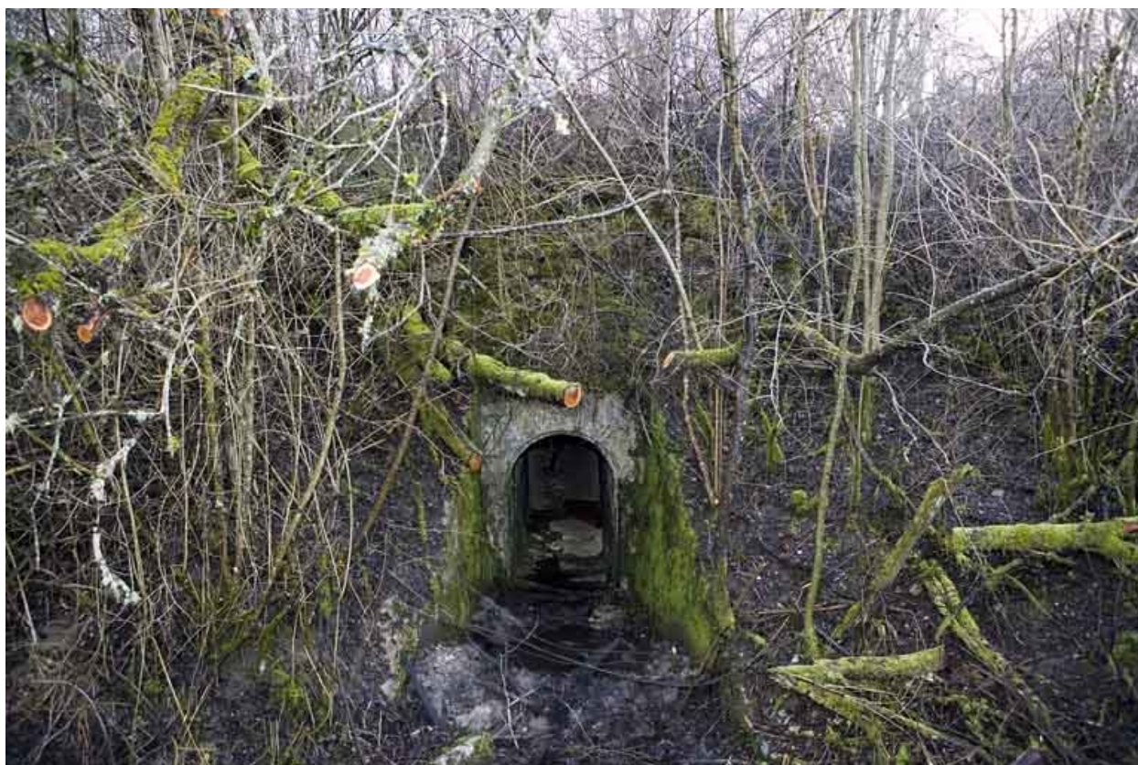
Réservoir, Pâtur de Montsevely : aqueduc d'évacuation.
