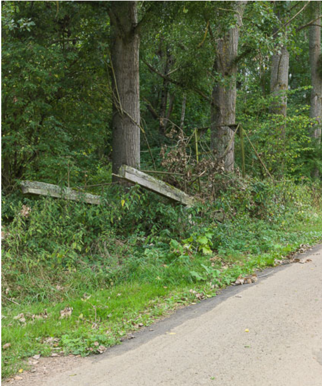
Ancienne passerelle abandonnée.
