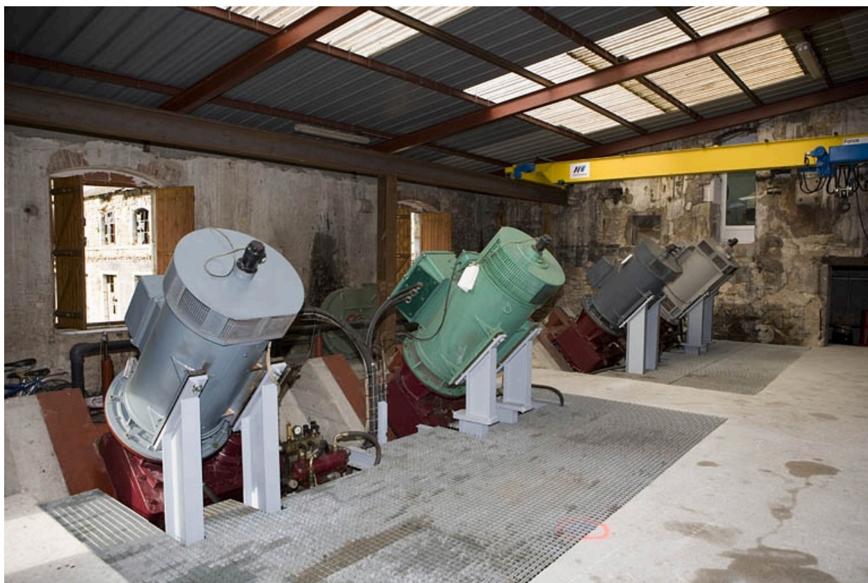
Bâtiment d'eau. Les turbines modernes.
