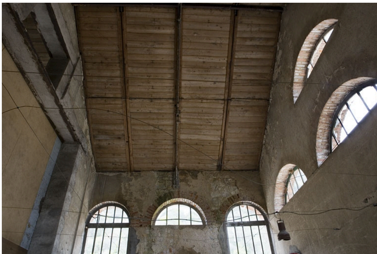
Atelier de réparation. Vue intérieure.
