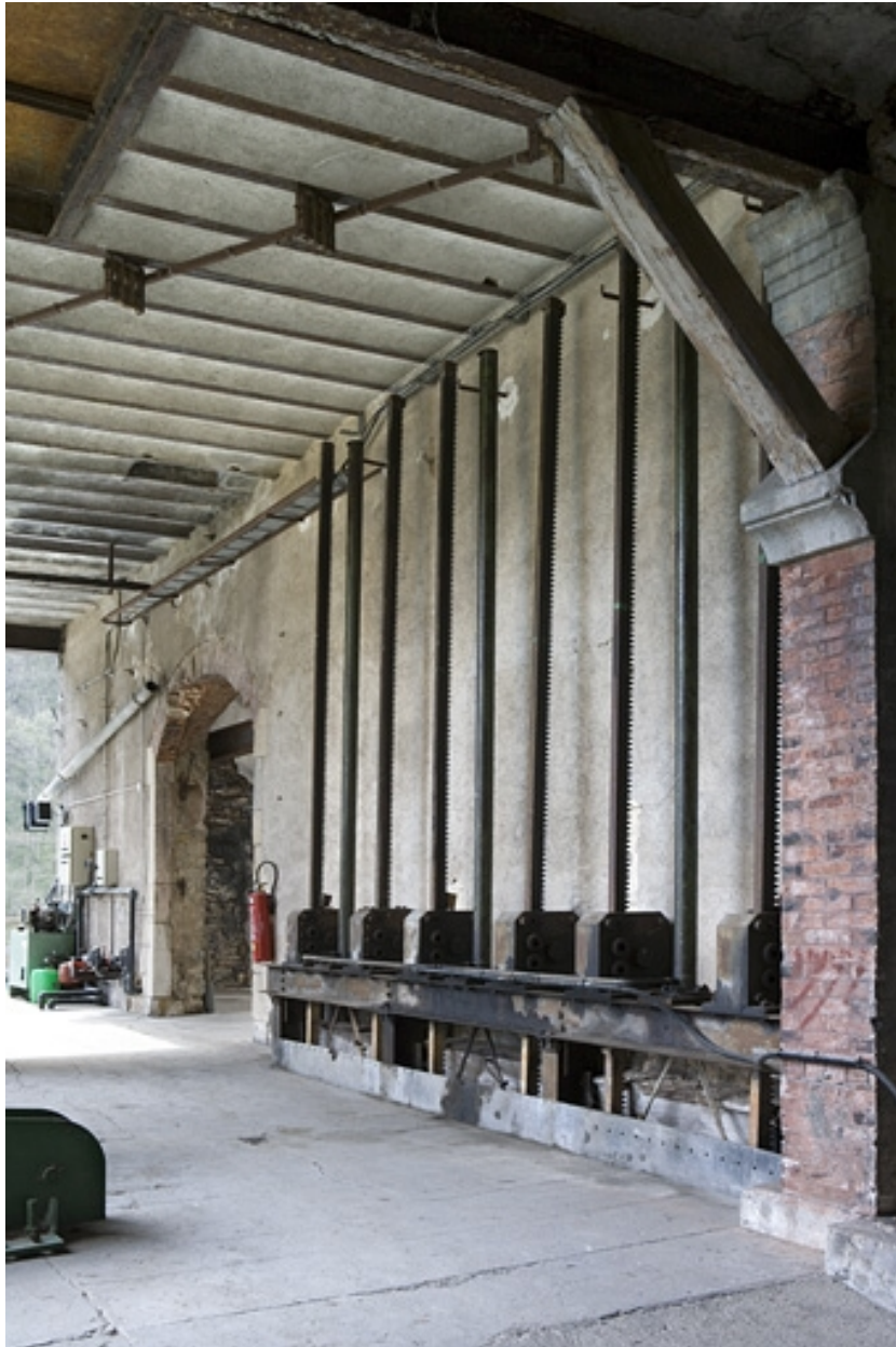
Bâtiment d'eau. Vue rapprochée du système Fontaine.
