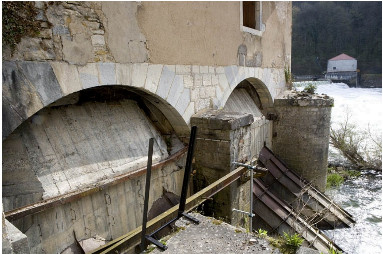
Bâtiment d'eau. Conduites d'évacuation d'eau.
