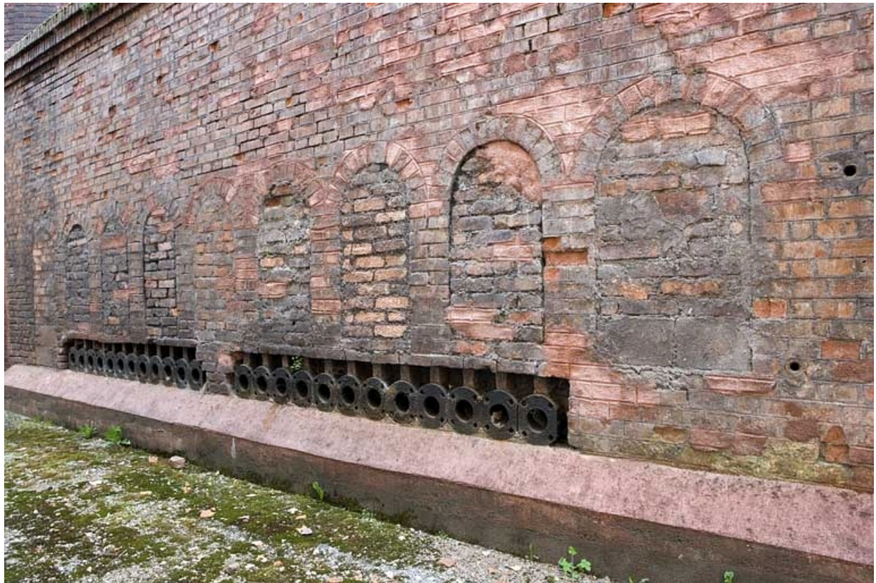
Orifices des tubes de la chaudière.
