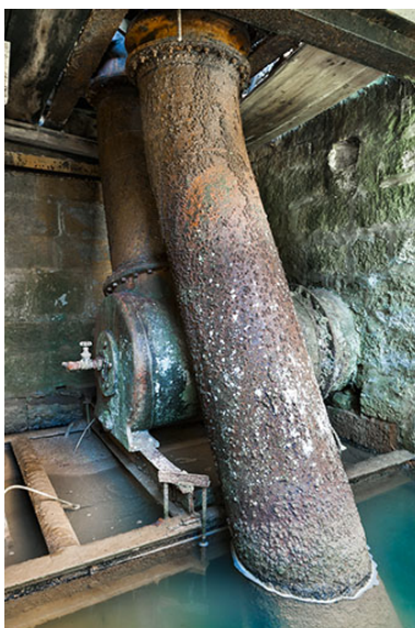
Turbine hydraulique (partie inférieure). Phot. Jérôme Mongreville IVR43_20132500659NUC4A
