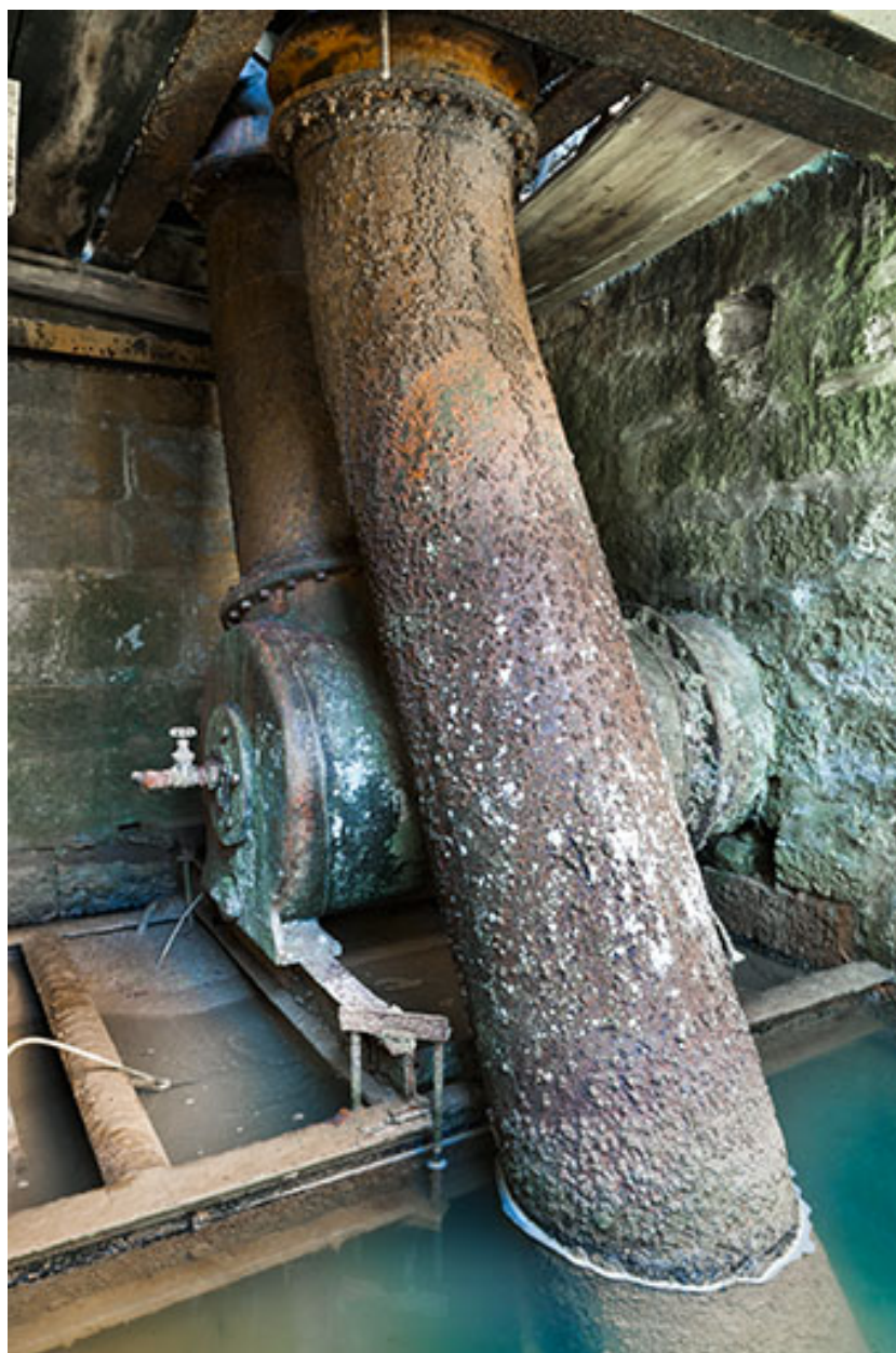
Turbine hydraulique (partie inférieure).
