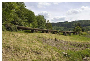
Conduite forcée de la centrale hydroélectrique. Phot. Jérôme Mongreville IVR43_20057000323NUCA
