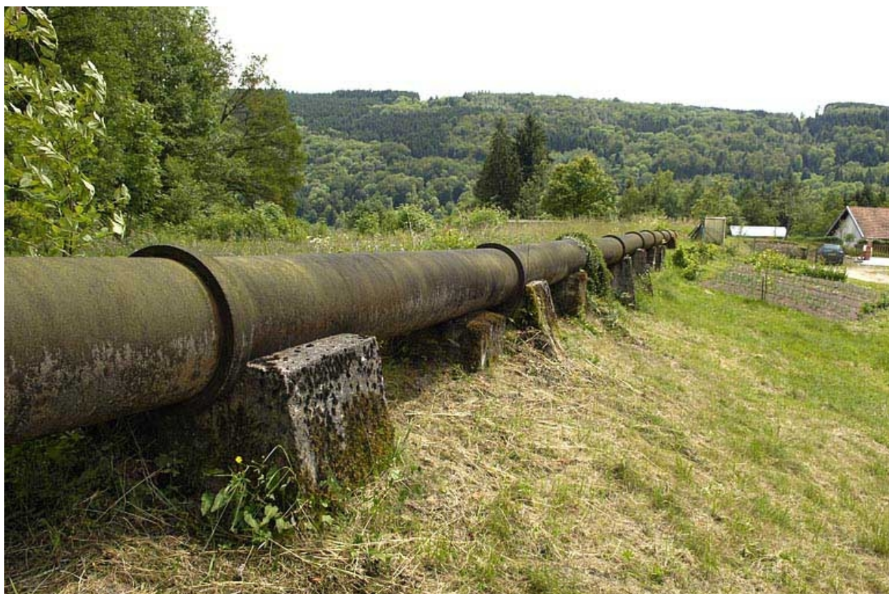
Détail de la conduite forcée.
