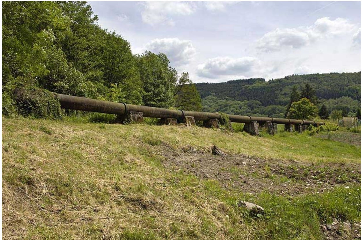
Conduite forcée de la centrale hydroélectrique.
