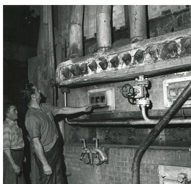
Surveillance des chaudières, fotogr., s.d. [3e quart 20e siècle]. IVR43_20152501957NUC4A
