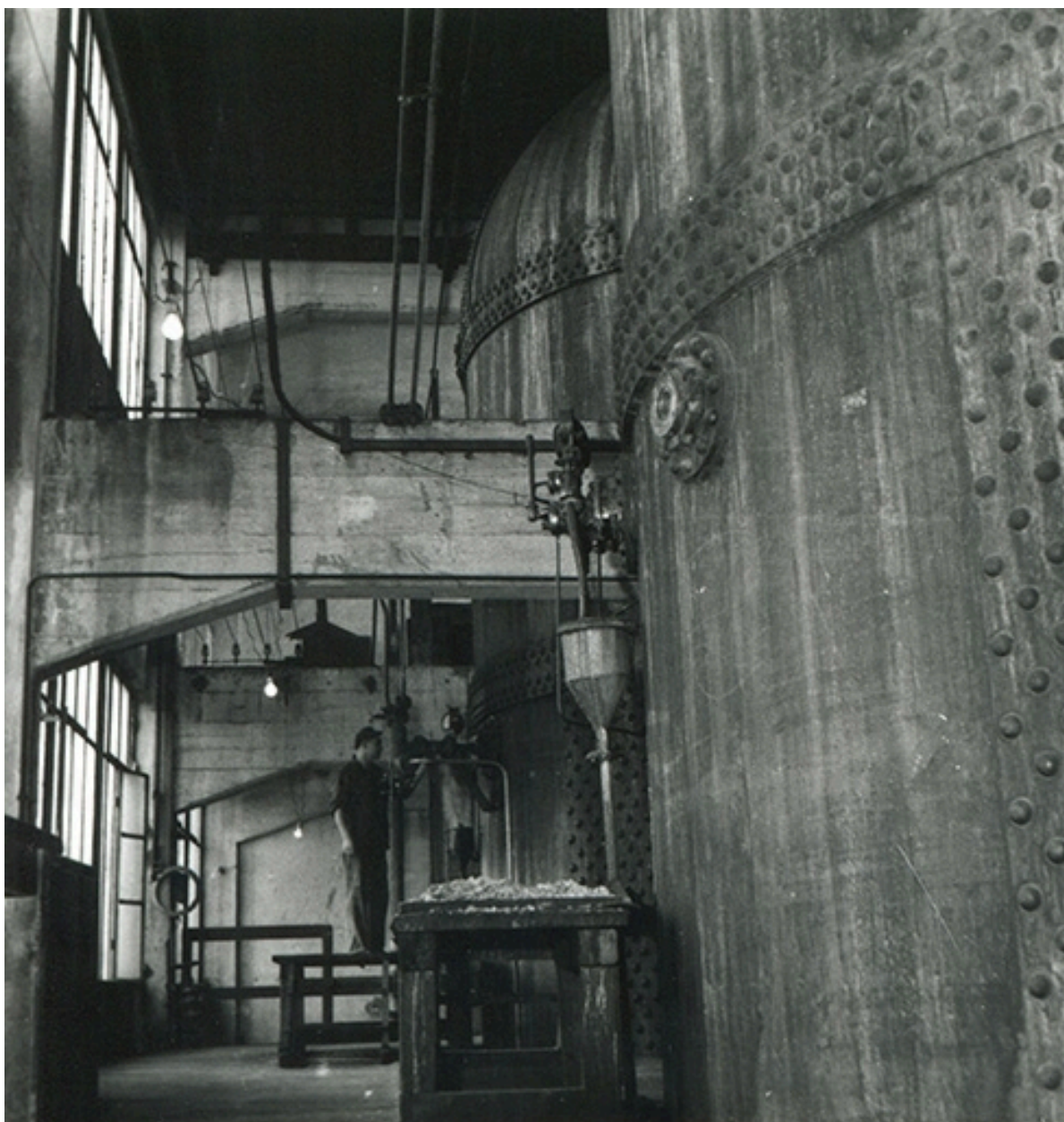
Chaudières (?), fotogr., s.d. [3e quart 20e siècle].
