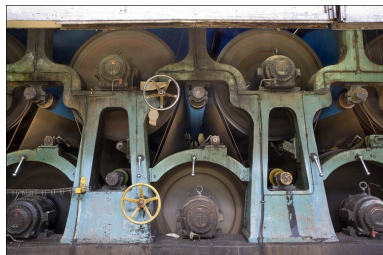
Machine à papier. Détail des cylindres de la sécherie.
