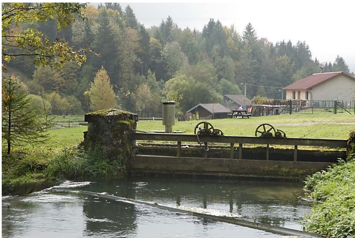
Vannage de prise d'eau.
