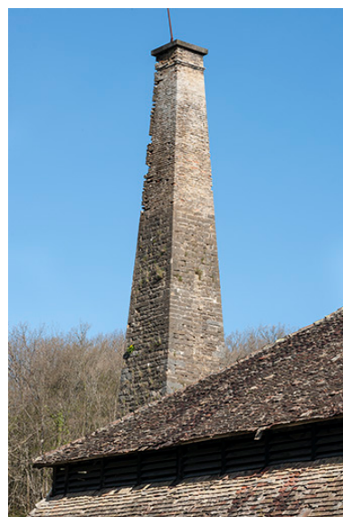
La cheminée de la chaufferie. Phot. Jérôme Mongreville IVR43_20152501086NUC4A
