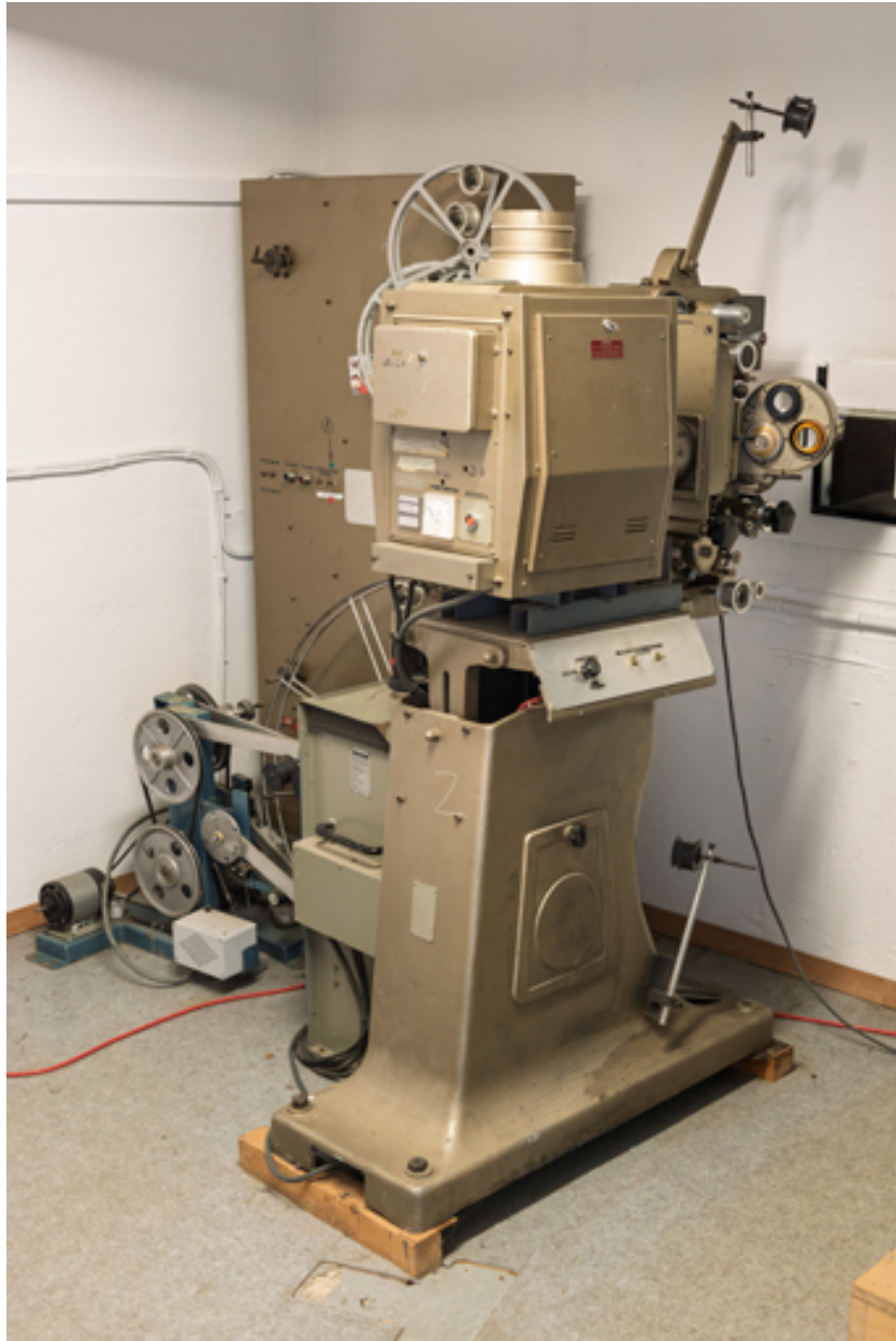
Cabine de projection : projecteur argentique Prevest.
