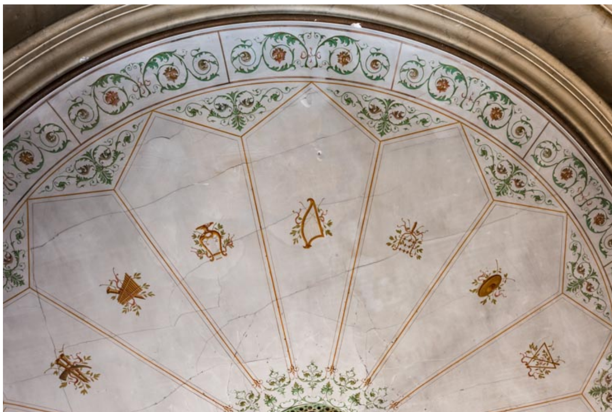
Peinture du plafond : détail.
