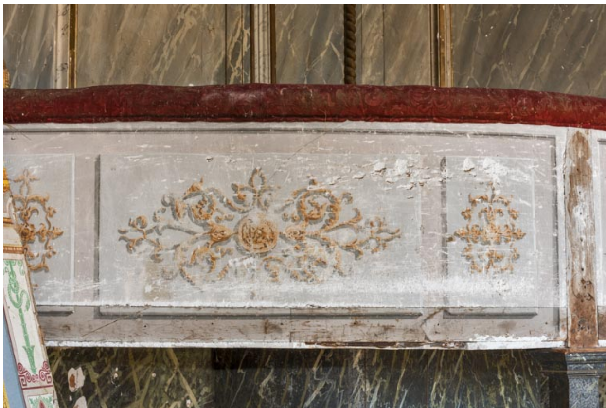
Peinture sur le garde-corps du balcon.
