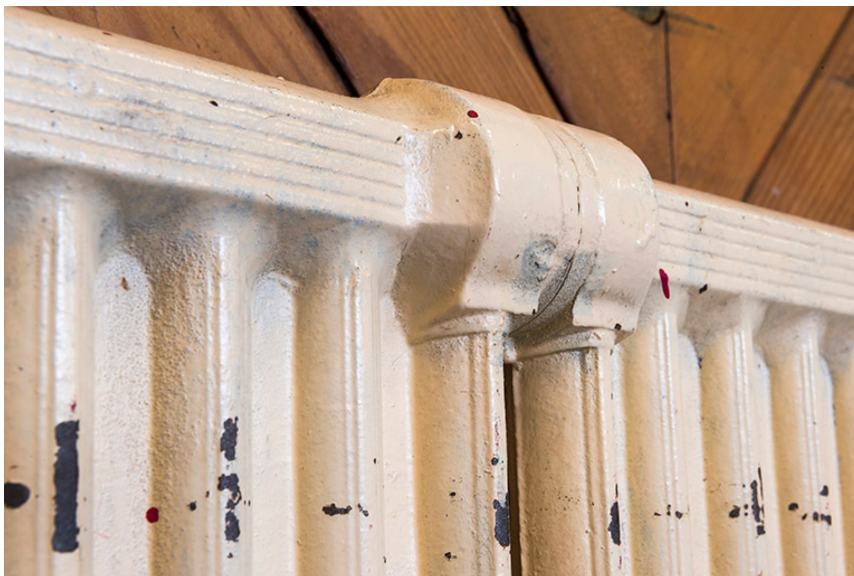
Détail d'un des radiateurs en fonte.
