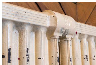
Détail d'un des radiateurs en fonte. Phot. Jérôme Mongreville IVR43_20177001136NUC4A
