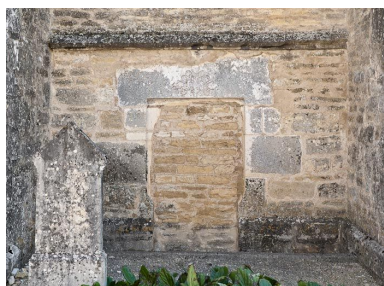
Porte latérale gauche murée.
