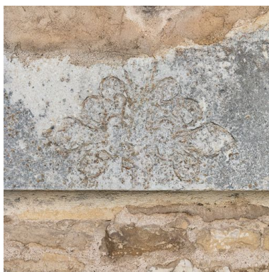
Linteau de la porte latérale gauche murée.
