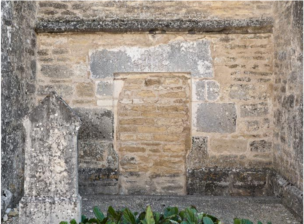
Porte latérale gauche murée.
