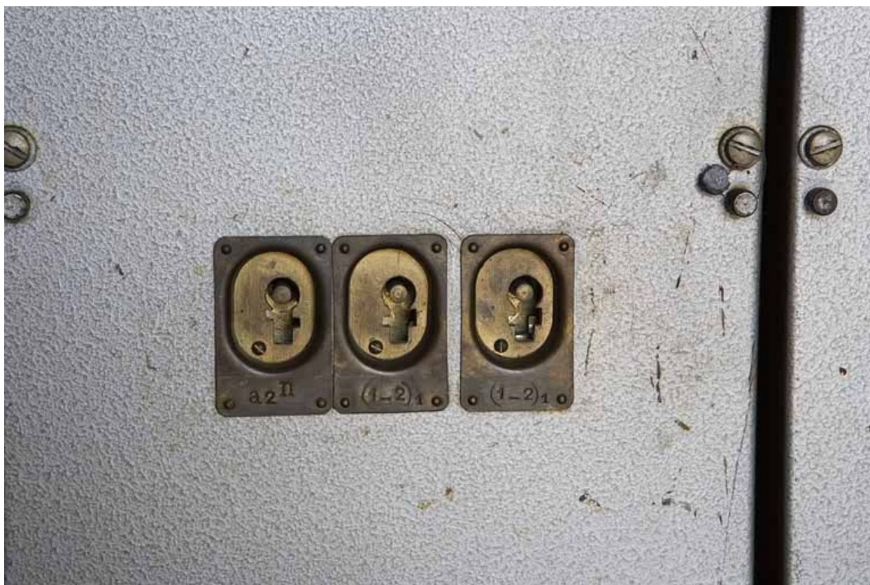
Bureau : serrures du transmetteur central.
