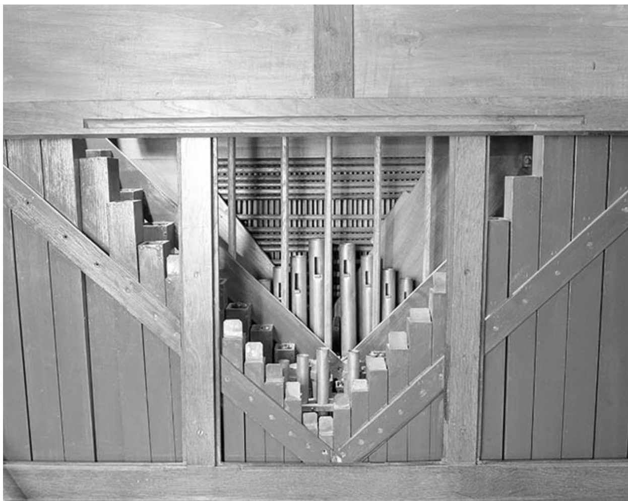
Tuyauterie vue de face.
