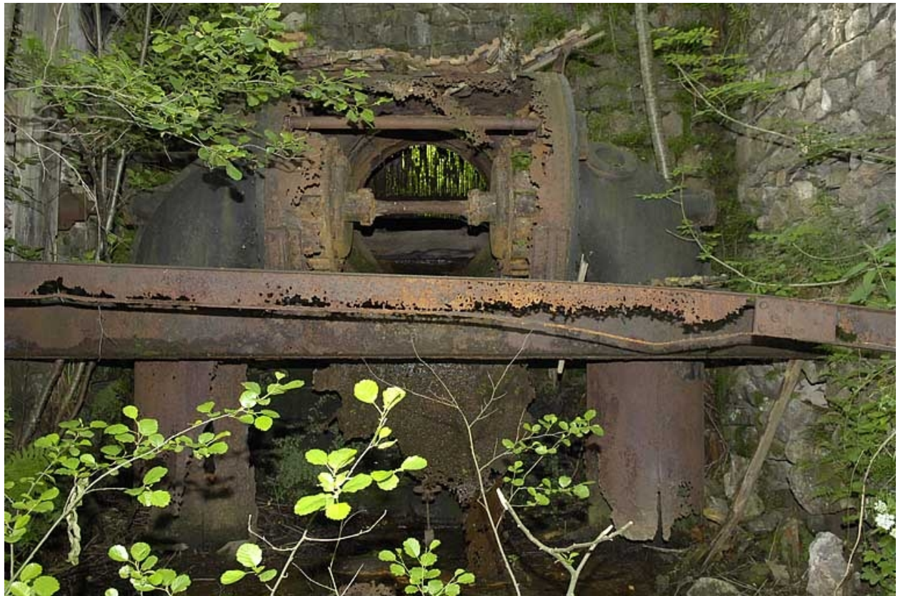
Turbine hydraulique à axe horizontal. Vue rapprochée.
