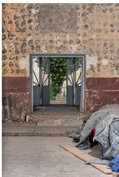
Salle : entrée. Phot. Pierre-Marie Barbe-Richaud IVR26_20235800175NUC4A
