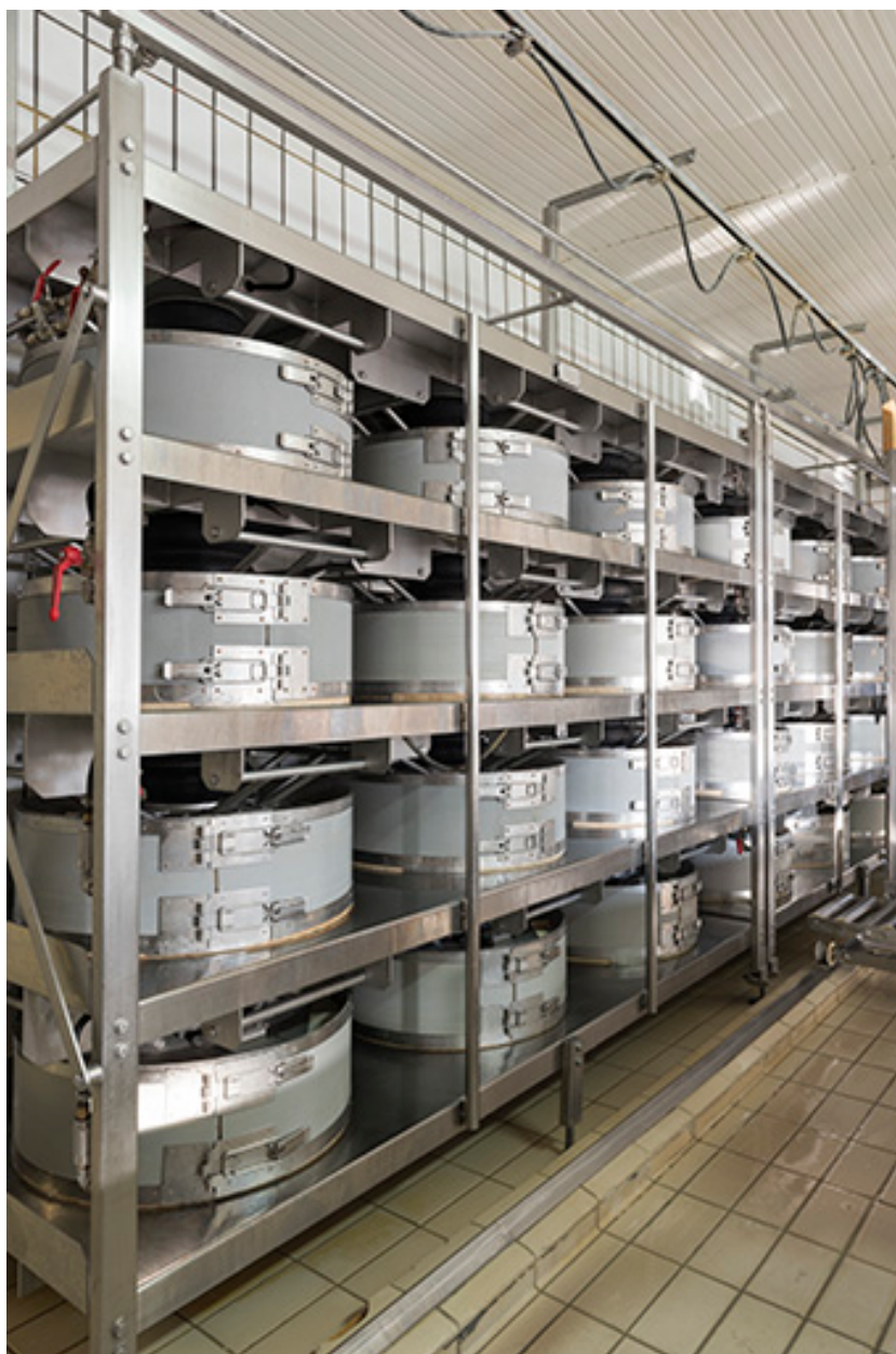
Atelier de fabrication : installation de pressage pneumatique.
