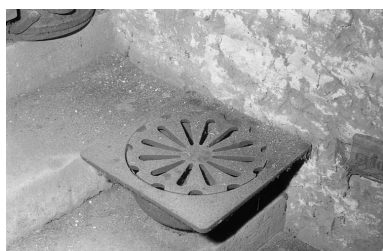
Regard d'eau pluviale. Phot. Dominique Dominguez IVR43_19817000063Z
