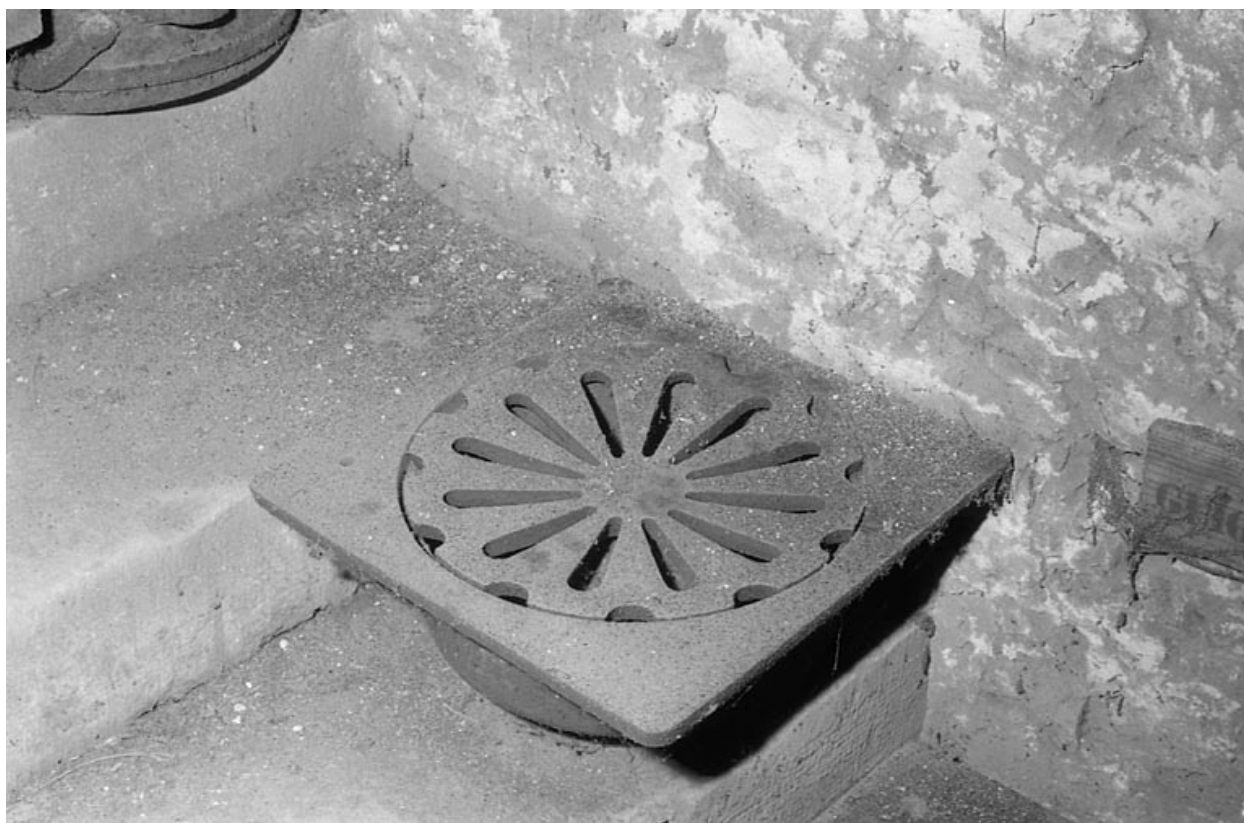
Regard d'eau pluviale.
