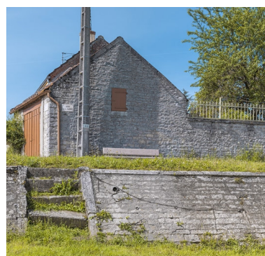
Escalier de sauvetage. Phot. Thierry Kuntz IVR26_20172100188NUC4A
