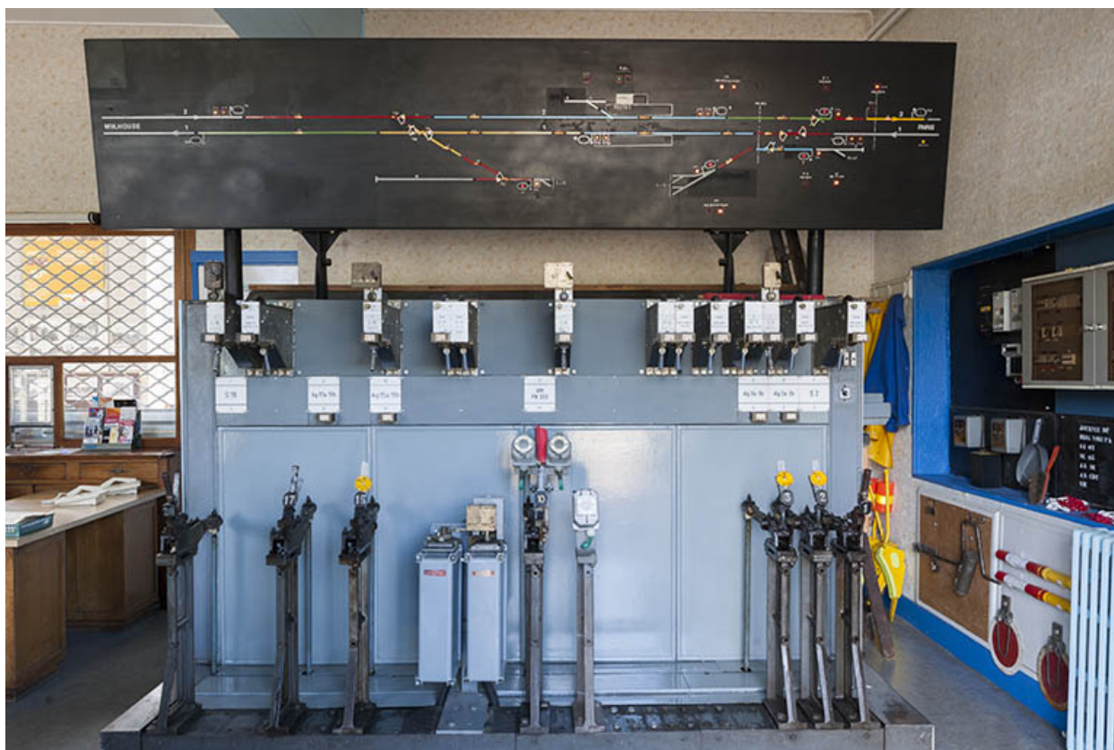
Gare de Port-d'Atelier : intérieur du poste d'aiguillage.
