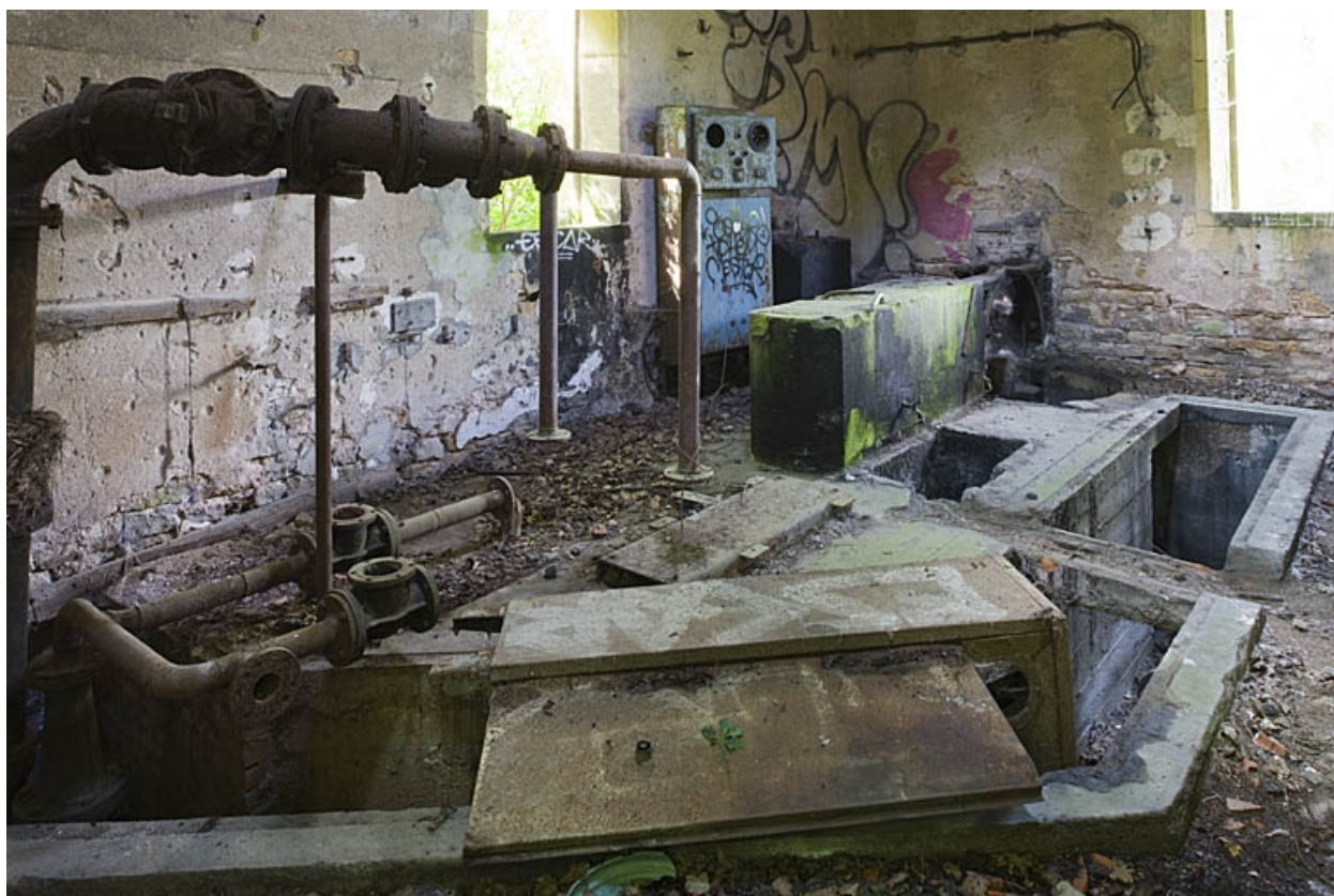
Station de pompage : vue rapprochée de l'intérieur.
