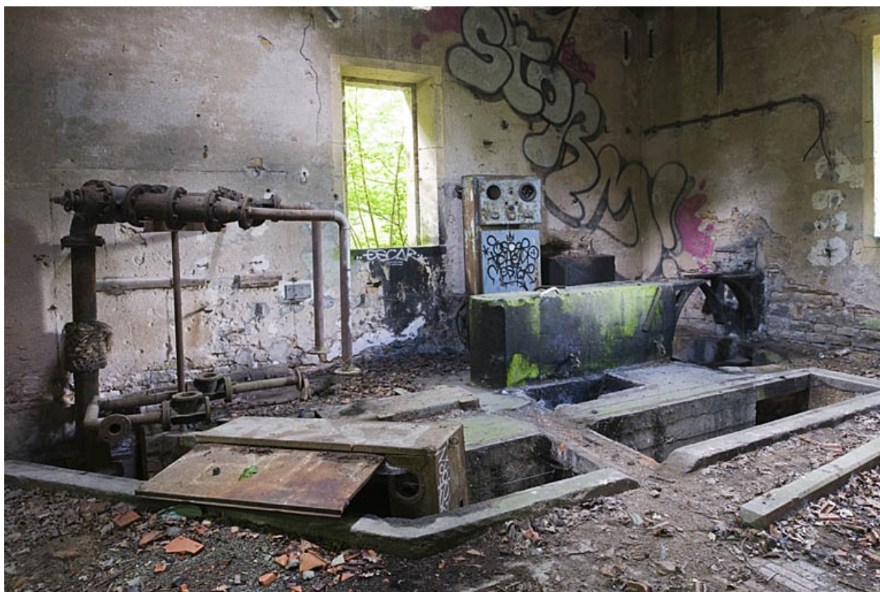
Station de pompage : Intérieur.
