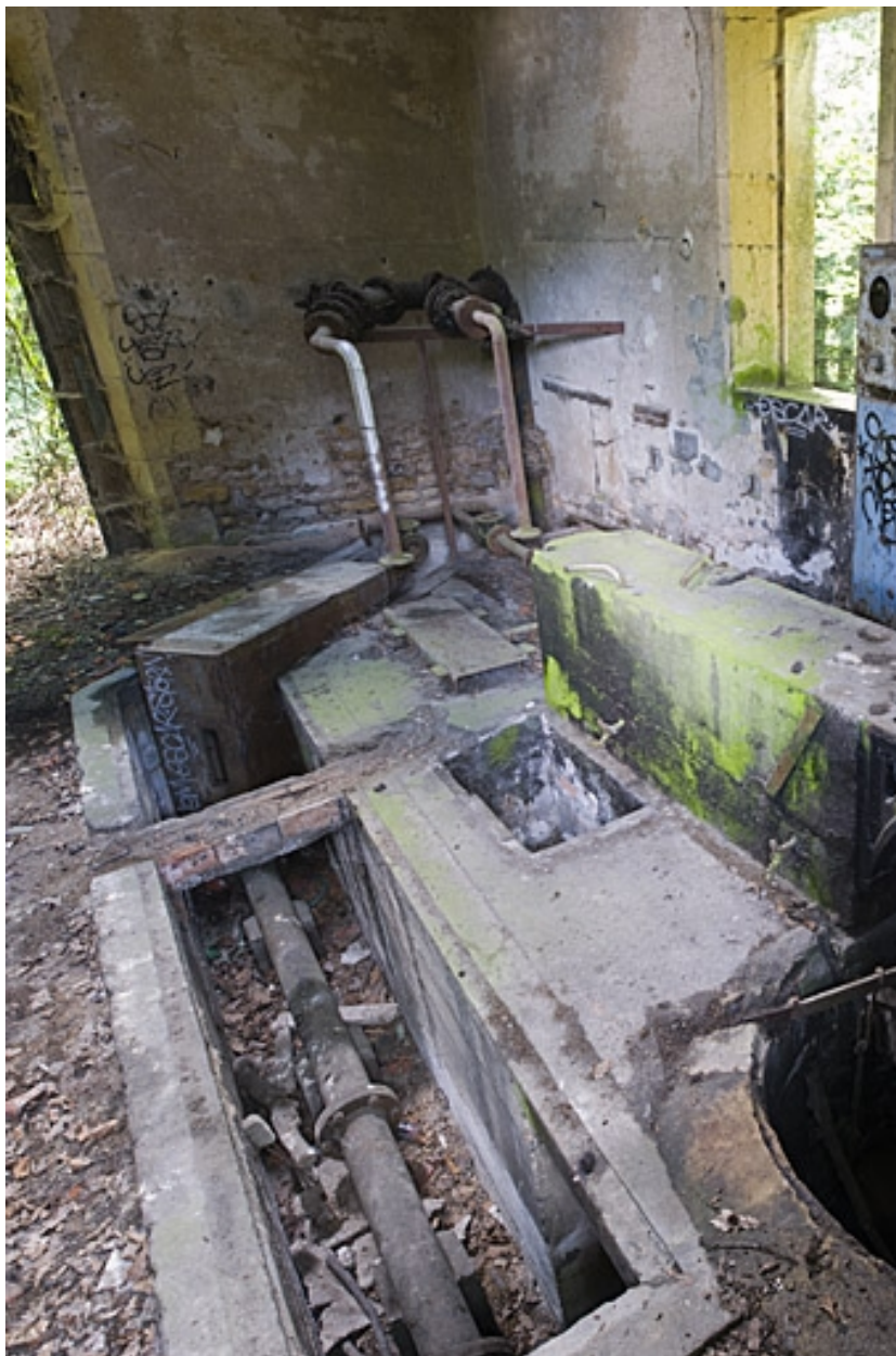
Station de pompage : détail de l'intérieur.
