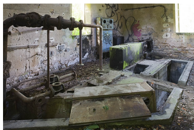
Station de pompage : vue rapprochée de l'intérieur. Phot. Marc Loukachine IVR43_20127000142NUC4A
