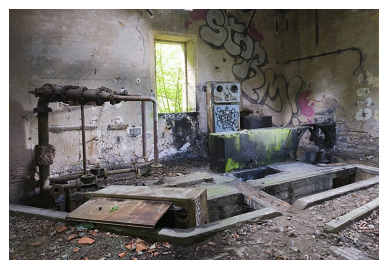
Station de pompage : Intérieur. Phot. Marc Loukachine IVR43_20127000141NUC4A
