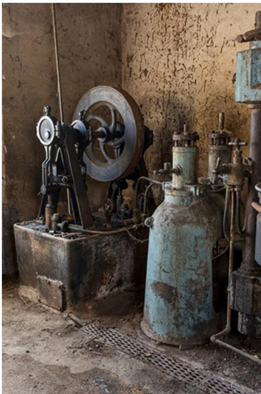
Machines du rez-de-chaussée: pompe hydraulique et régulateur
