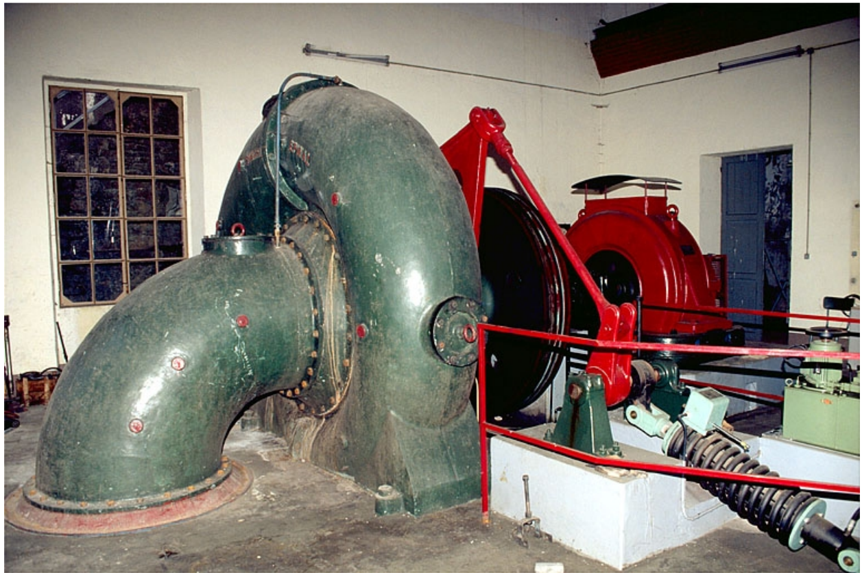
Vue rapprochée de la turbine n° 3.
