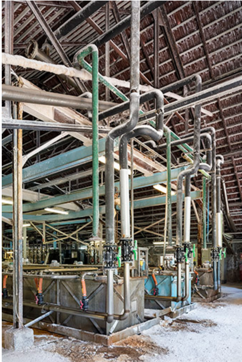
Fabrication : retraitement du sel (cristallisation).
