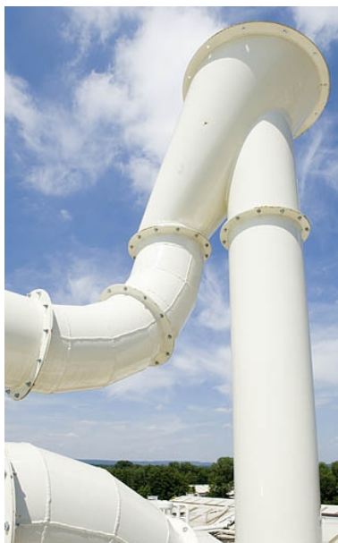
Tuyauterie d'un silo. Phot. Jérôme Mongreville IVR43_20097000465NUC2A
