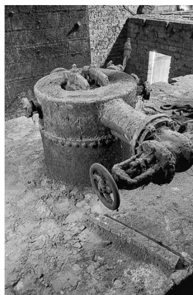
Partie supérieure de la chaudière. Vannage.
