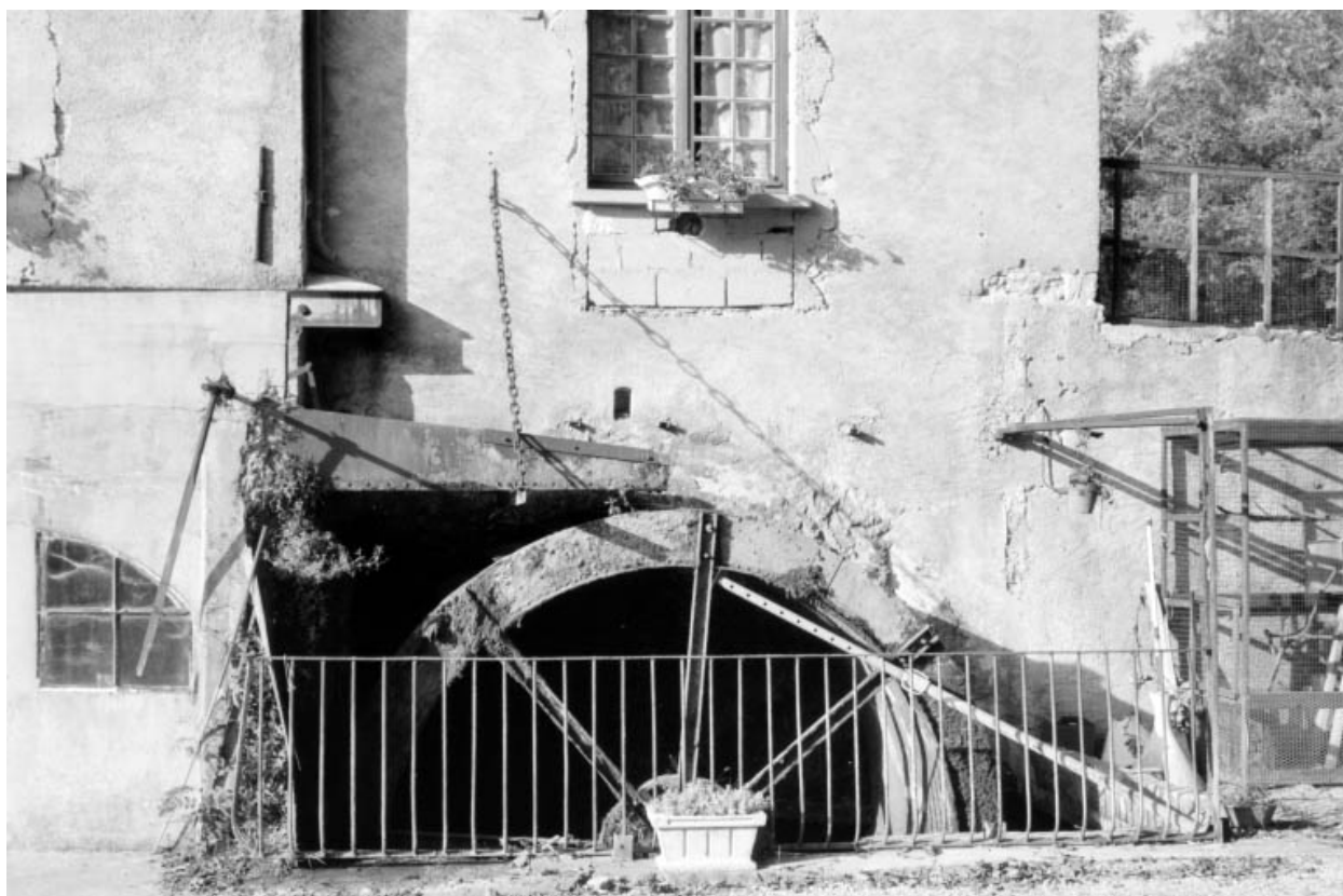
Roue en dessus et conduite d'amenée.
