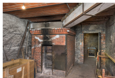
Calorifère au sous-sol. Phot. Pierre-Marie Barbe-Richaud IVR26_20245800204NUC4A
