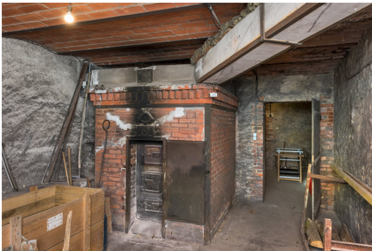
Calorifère au sous-sol.
