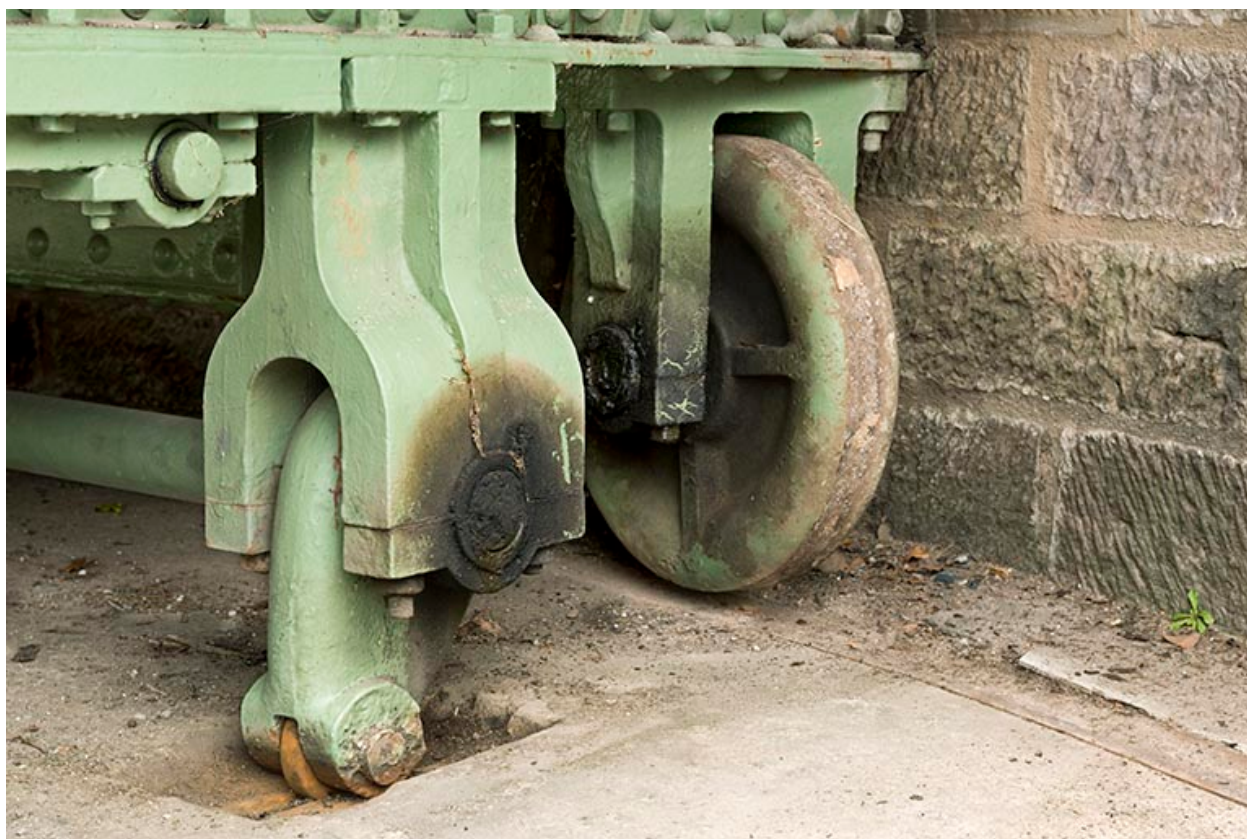
Système de calage baissé (côté amont).
