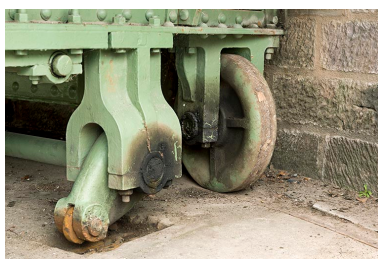
Système de calage levé (côté amont).
