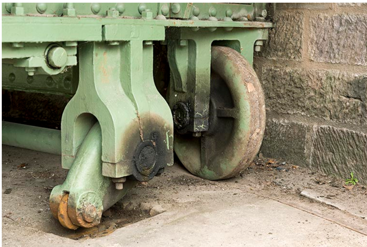
Système de calage levé (côté amont).
