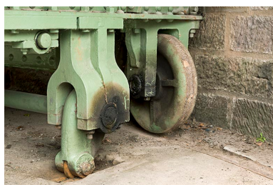
Système de calage baissé (côté amont).
