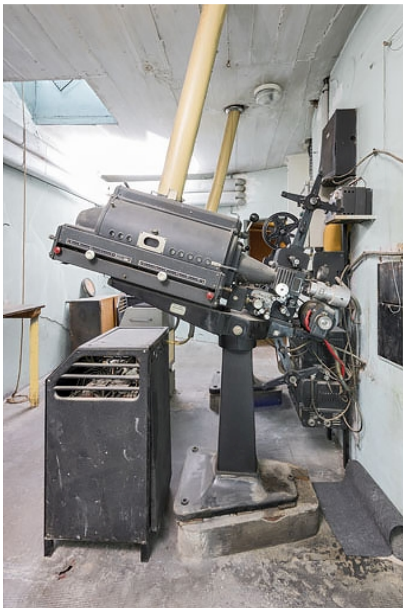
Projecteur côté cour et son redresseur.
