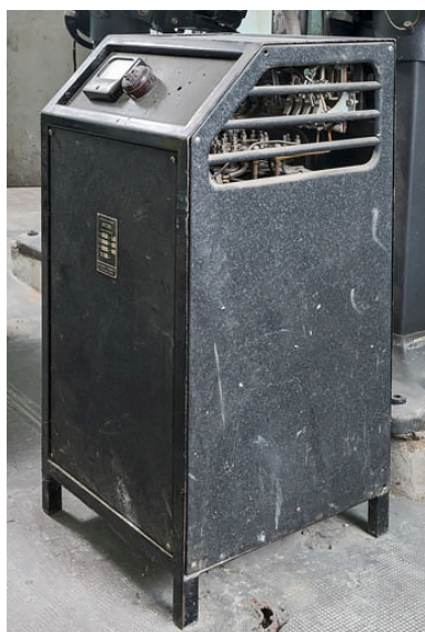
Redresseur Rectarc désaffecté. Phot. Pierre-Marie Barbe-Richaud IVR26_20222100055NUC4A
