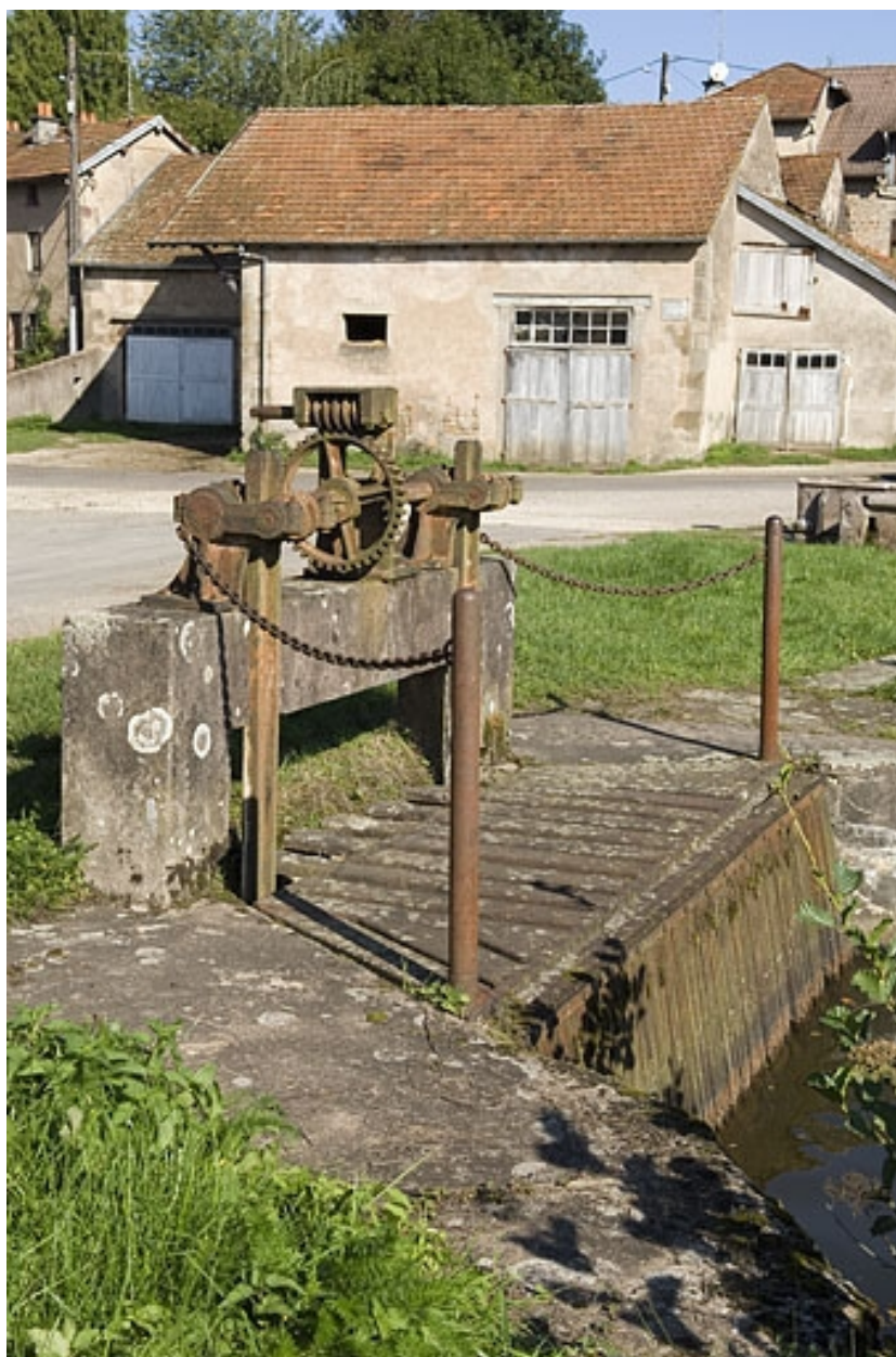
Vanne de prise d'eau de l'étang.
