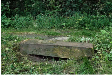
Linteau restant du pont des Freteurs.
