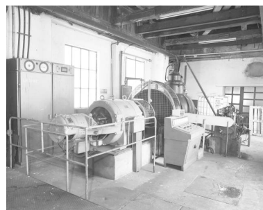
Turbine. Vue générale. Phot. Jérôme Mongreville IVR43_20022500379X
