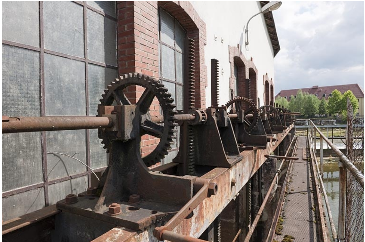
Détail du vannage de prise d'eau.
