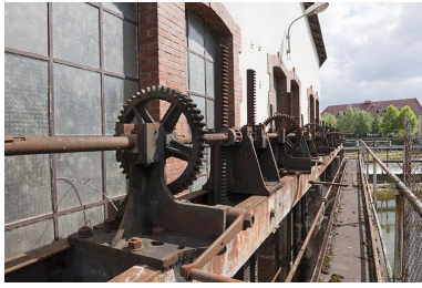
Détail du vannage de prise d'eau. Phot. Jérôme Mongreville IVR43_20112501602NUC4A
