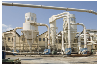
Installation de traitement de la sciure. Phot. Jérôme Mongreville IVR43_20097000758NUC2A
