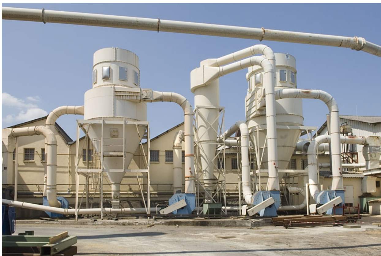
Installation de traitement de la sciure.
