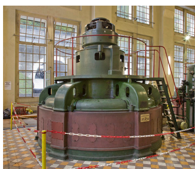
Centrale de Liebwillers : alternateur du groupe n° 4.
