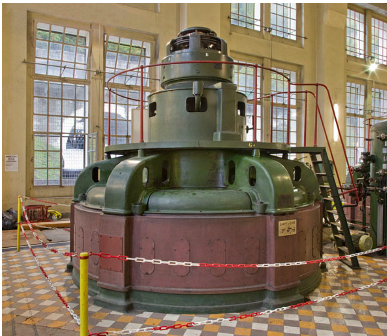
Centrale de Liebvillers : alternateur du groupe n° 4.
