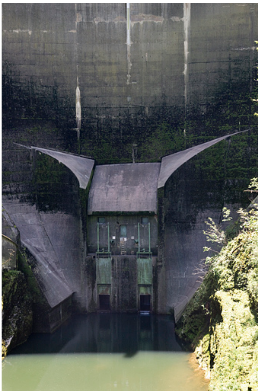
Barrage du Châtelot : vannes de fond.
