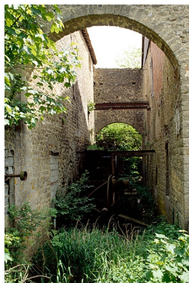
Bâtiment d'eau. Roues hydrauliques en ruine. Phot. Jérôme Mongreville IVR43_19963900494ZA
