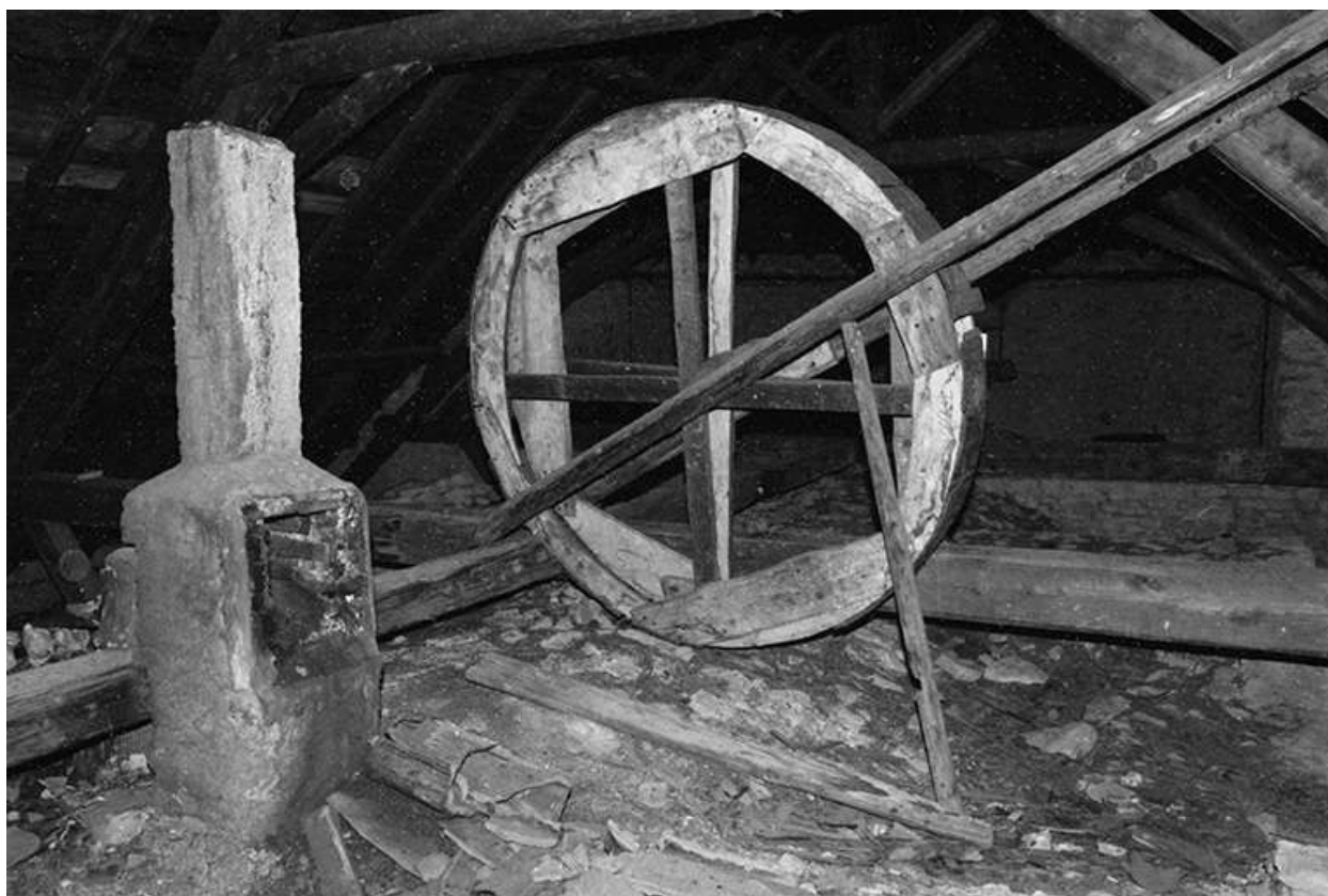
Combles : l'un des treuils.
