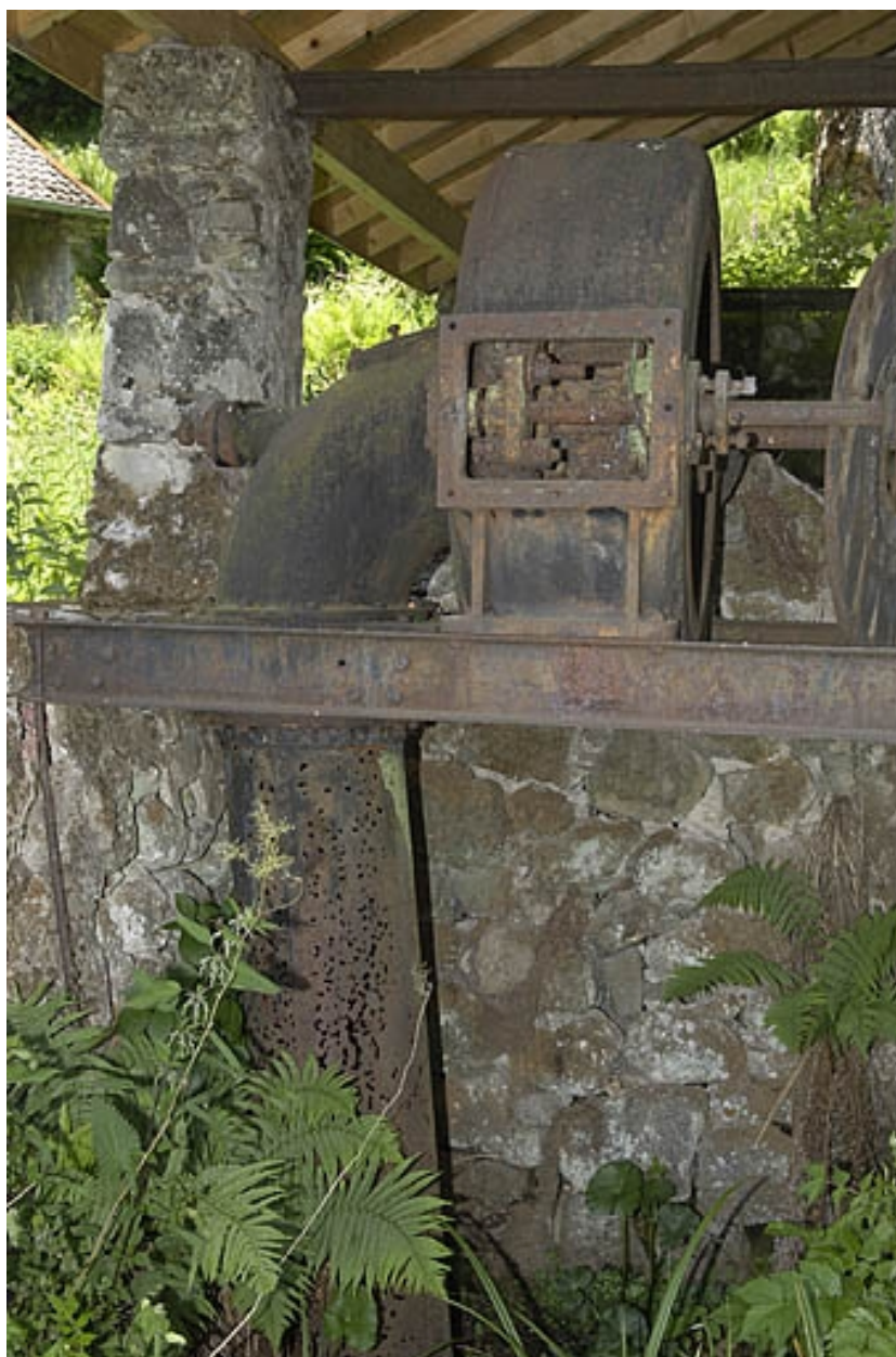
Turbine horizontale et sa conduite d'évacuation.
