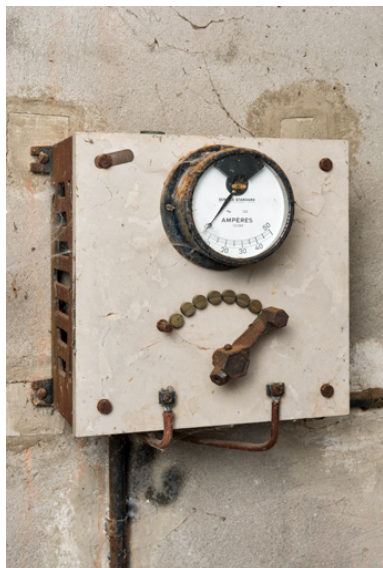
Cabine de projection : un rhéostat. Phot. Pierre-Marie Barbe-Richaud IVR26_20245800329NUC4A
