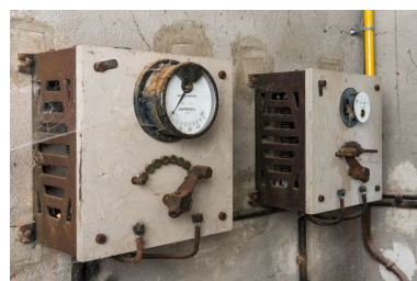
Cabine de projection : rhéostats. Phot. Pierre-Marie Barbe-Richaud IVR26_20245800328NUC4A
