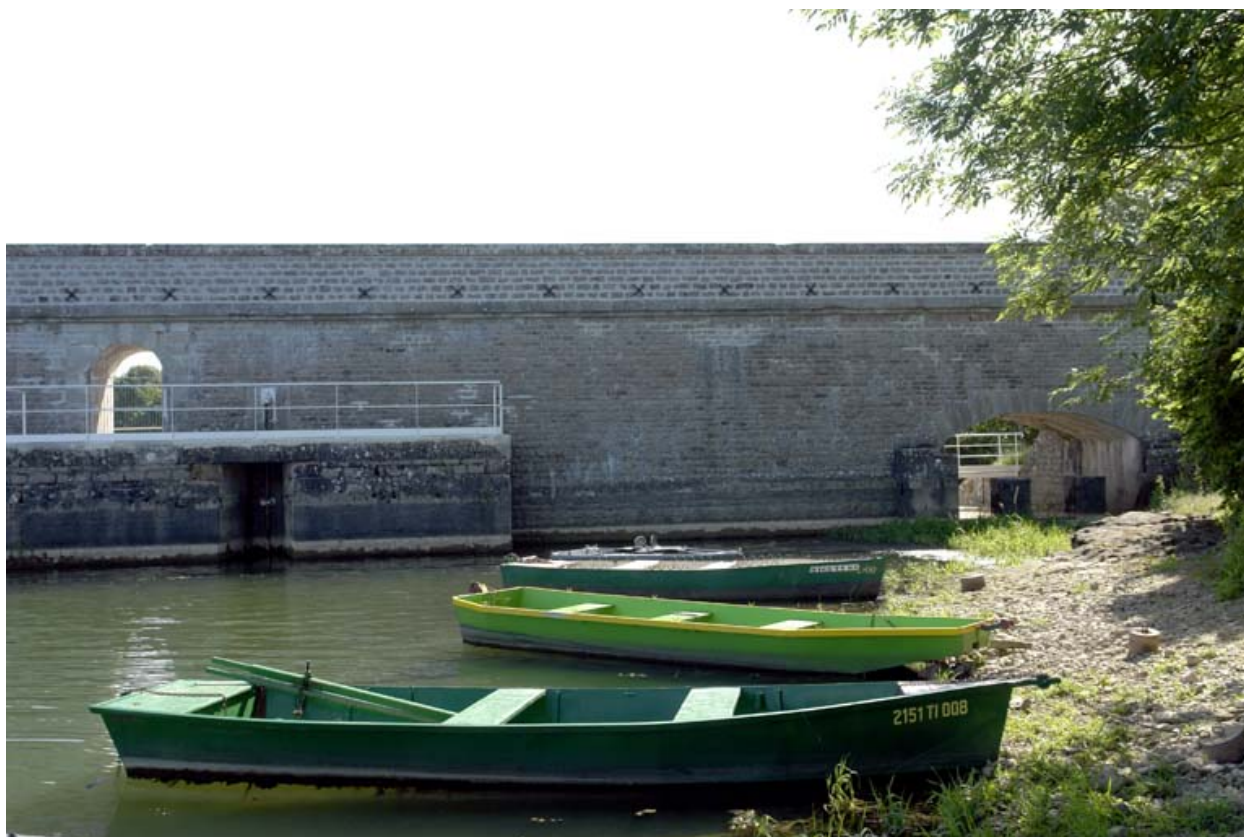
Vanne de fond et déversoir de superficie.
