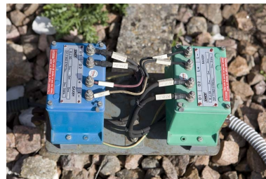
Boîtes de jonction. Phot. Yves Sancey IVR43_20083900910NUC2A
