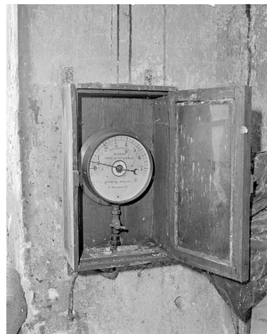
Placé dans l'atelier de mécanique, au-dessus de la pompe, ce cadran permettait de contrôler le niveau d'eau du réservoir. Phot. Yves Sancey IVR43_20022501018X
