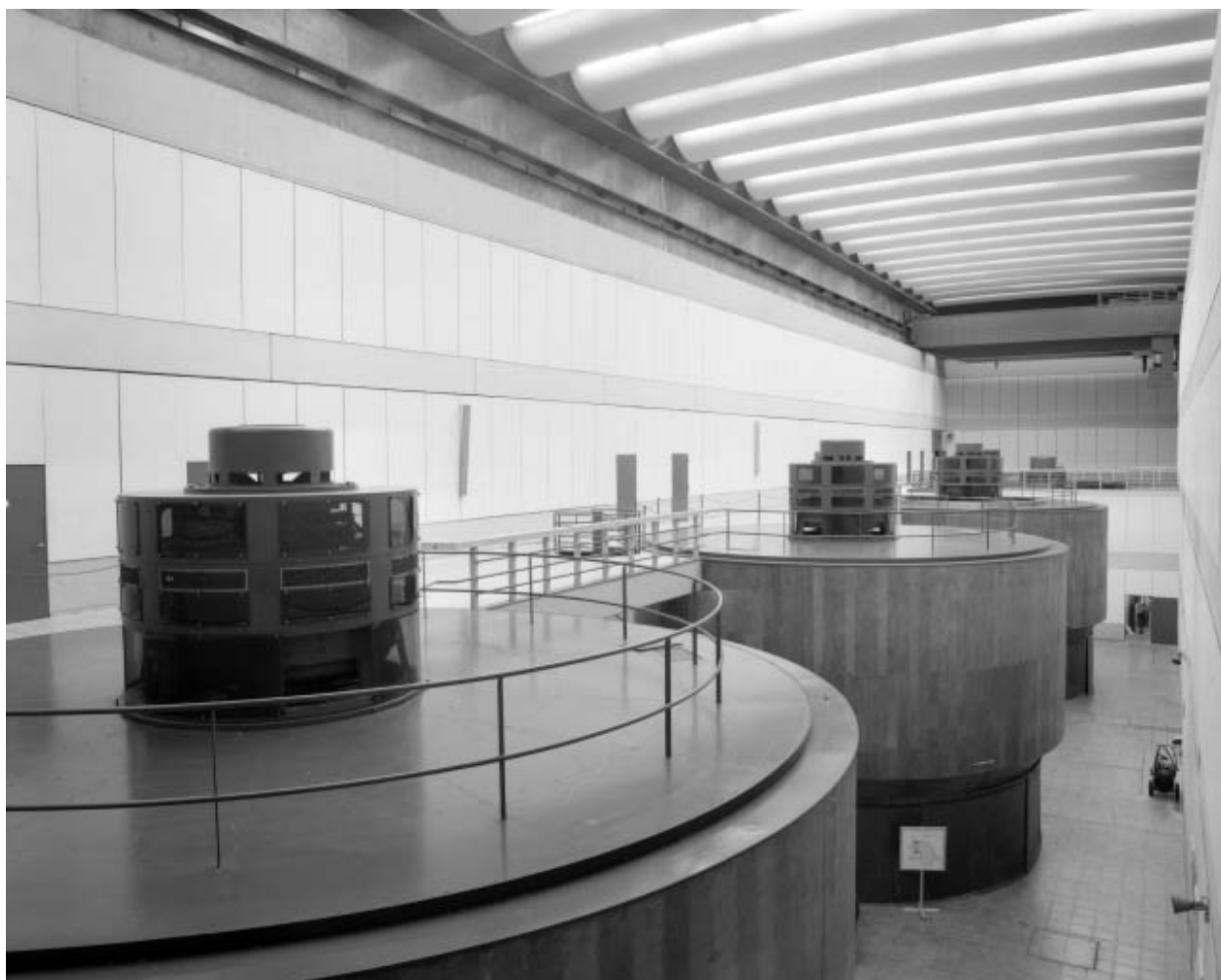
Barrage de Vouglans, Cernon : groupes n° 1 à 3.
