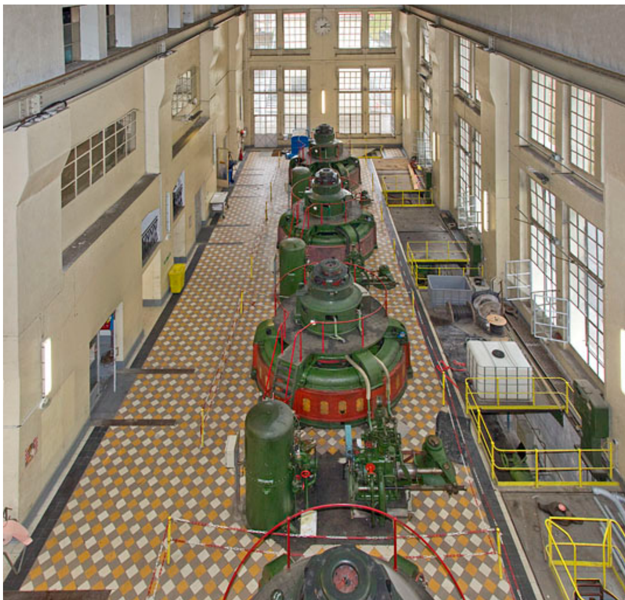
Centrale hydroélectrique de Liebvillers : intérieur.
