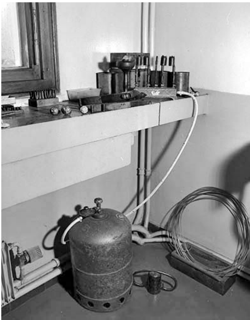
Vue d'ensemble du bec de gaz.
